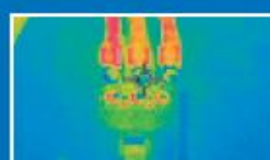
電気機器接合部分
