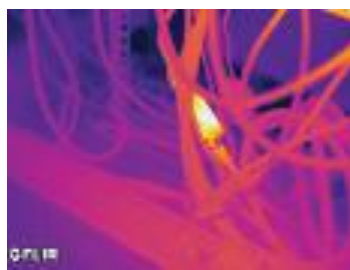
電気設備の不良
